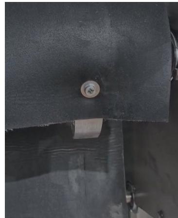
Arruela correta — funileiro 1/4" fixando o PVC
